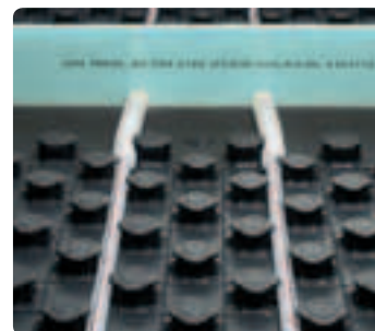
Leidinginstallatie met dilatatieprofiel
